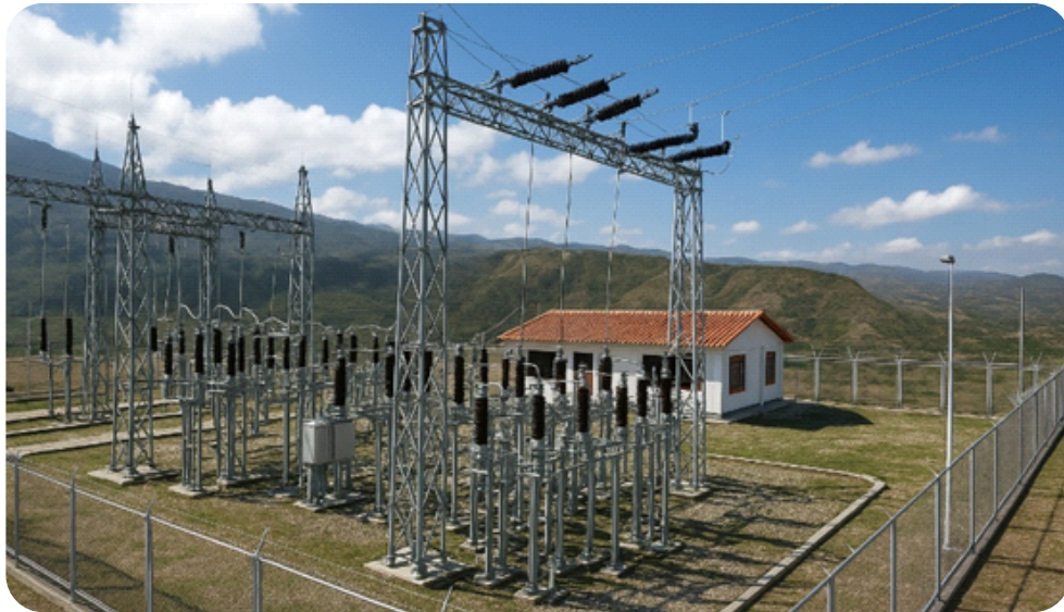
Subestación de conexión de la CH Potrero al SEIN en Aguas Calientes, Cajamarca
